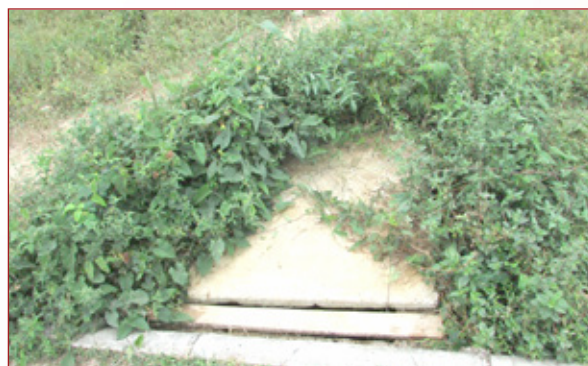
Tapa de alcantarillado anti técnica
